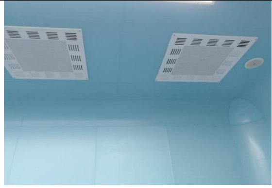
1号介入手术室内排风系统
